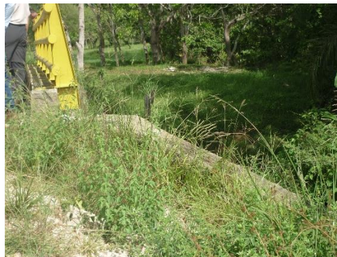
Socavación de material en aleta.
