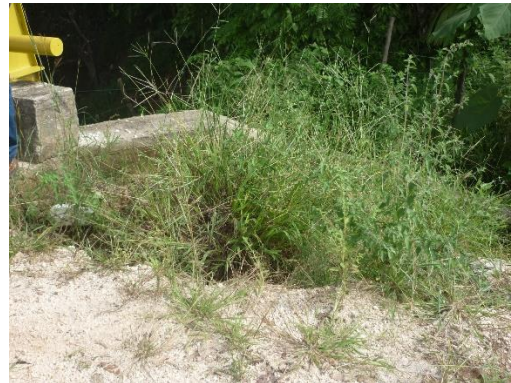
Socavación de material en aleta.
