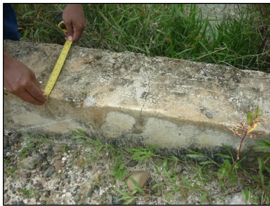
Fisuras en guarda rueda.
