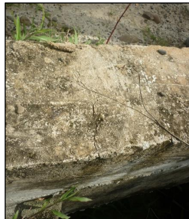
Fisuras en guarda rueda.
